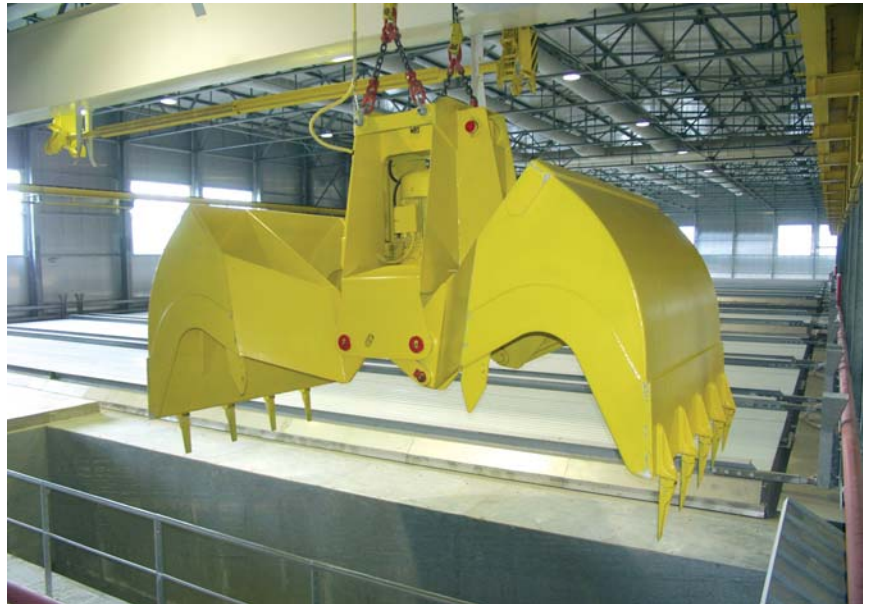
Carro ponte utilizzato per la movimentazione del rifiuto all'interno del compartimento di trattamento biologico.
